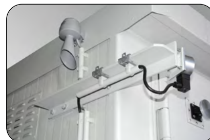
Türhalteanlage und Signalhupe für Ex-geschützte Abluftüberwachung
